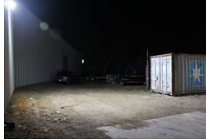
BLWP-60LED mounted 15` high illuminating a 30` long by 50` wide parking area./ BLWP- 60LED монтируется на высоту 15 ', освещая парковку длиной 30' и шириной 50'.
