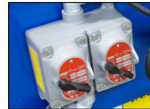
FAN & PUMP SWITCHES
